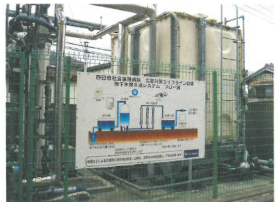
災害時給水施設
