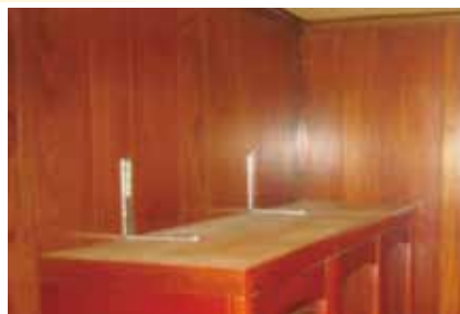
L型金具による家具の固定
